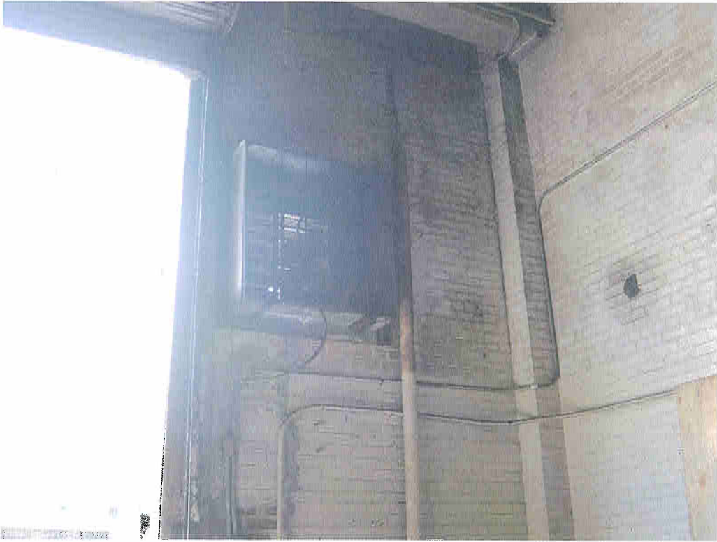
Exhaust fan and vent.
